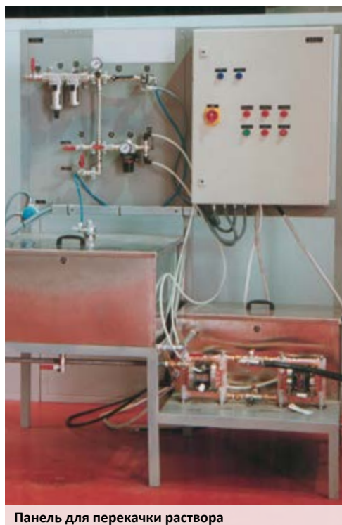
Панель для перекачки раствора
