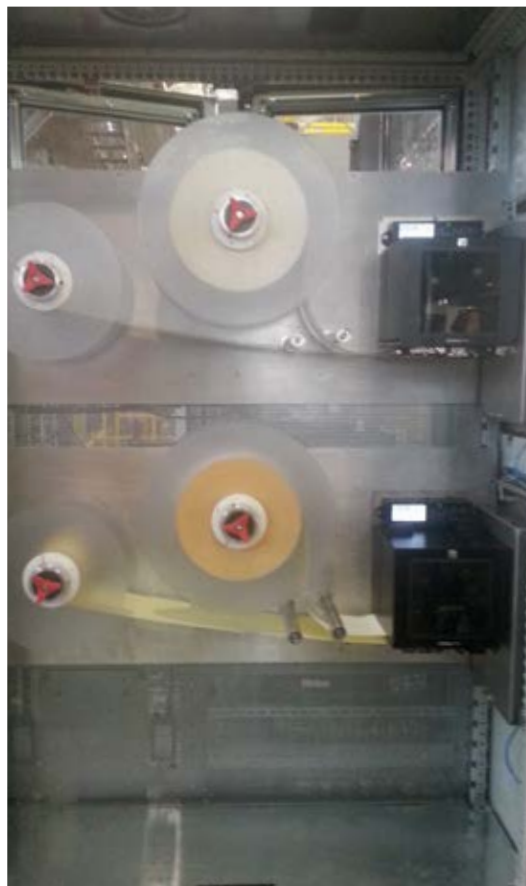
Электрошкаф с 2 принтерами
